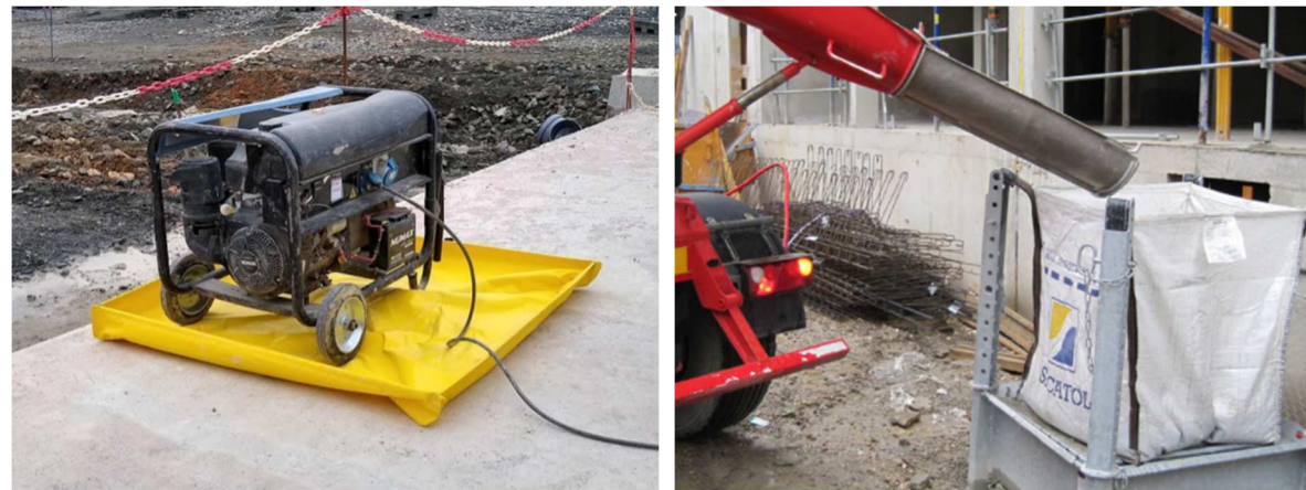
FIGURE 308 : GROUPE ELECTROGENE EQUIPE D'UN BAC DE RETENTION (SOURCE : INGEROP, 2020) – BIG BAG DE RECUPERATION DES DECHETS
